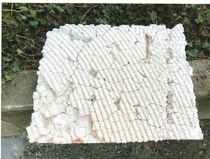
(4) Schwindrissbildungen im Dämmputz des zweiten Gebäudes: Hier haftete der Dämmputz am Deckputz und löste sich von der Haftgrundierung.
