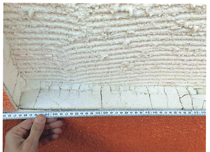
(5) Dämmputz mit Rissen, entweder ganz durchgehend oder aber ab Altputz (Haftgrundseite) bis Mitte des Dämmputzes
